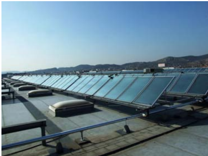
Napkollektormező, FPC 1036 m 2
