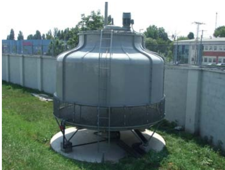
Nedves Hűtőtorony, ~ 700 kW
